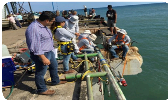
Seguimiento a los trabajos del ISCYC como parte del diagnóstico estructural del muelle del Puerto de La Libertad. 18 de julio de 2016.
